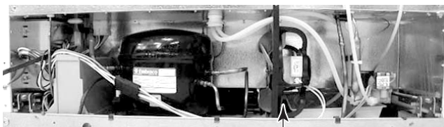
Condenser Fan Motor
