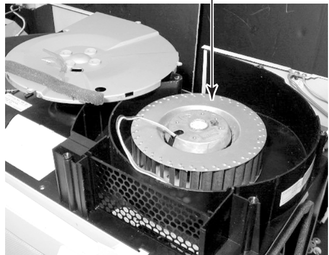
Hood Exhaust Fan Motor
