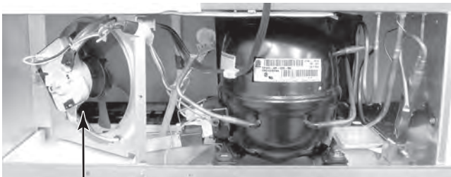
Condenser Fan Motor
